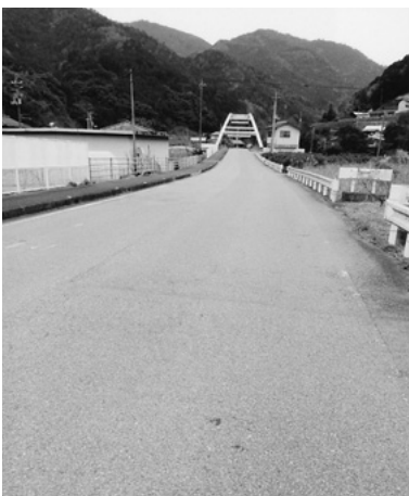
国道下分上山橋以西の中央白線の消えた現況
