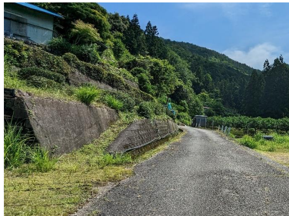
車道を整備する際に、コンクリート護岸や練石積みに切り替えられた道路擁壁
