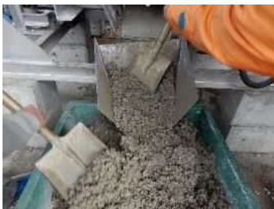
写真－４０ シュートの落下
