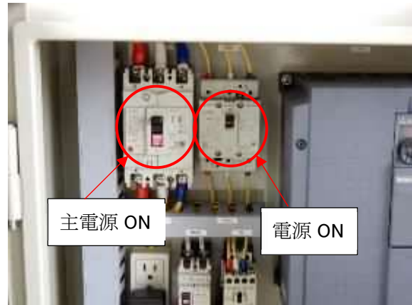
写真ー１８ 分電盤の主電源スイッチ
