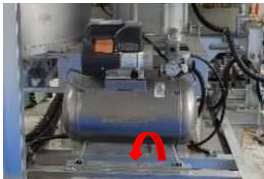
写真－３５ コンプレッサー
