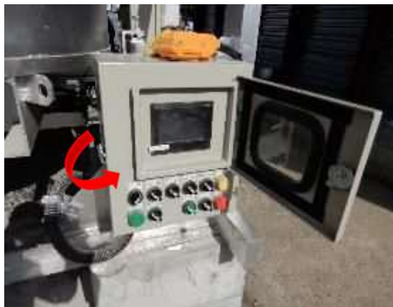
写真ー１７ 操作盤と SD カード挿入口
