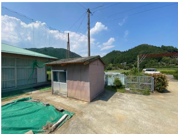
砂場前用具室 アスベスト含有調査
