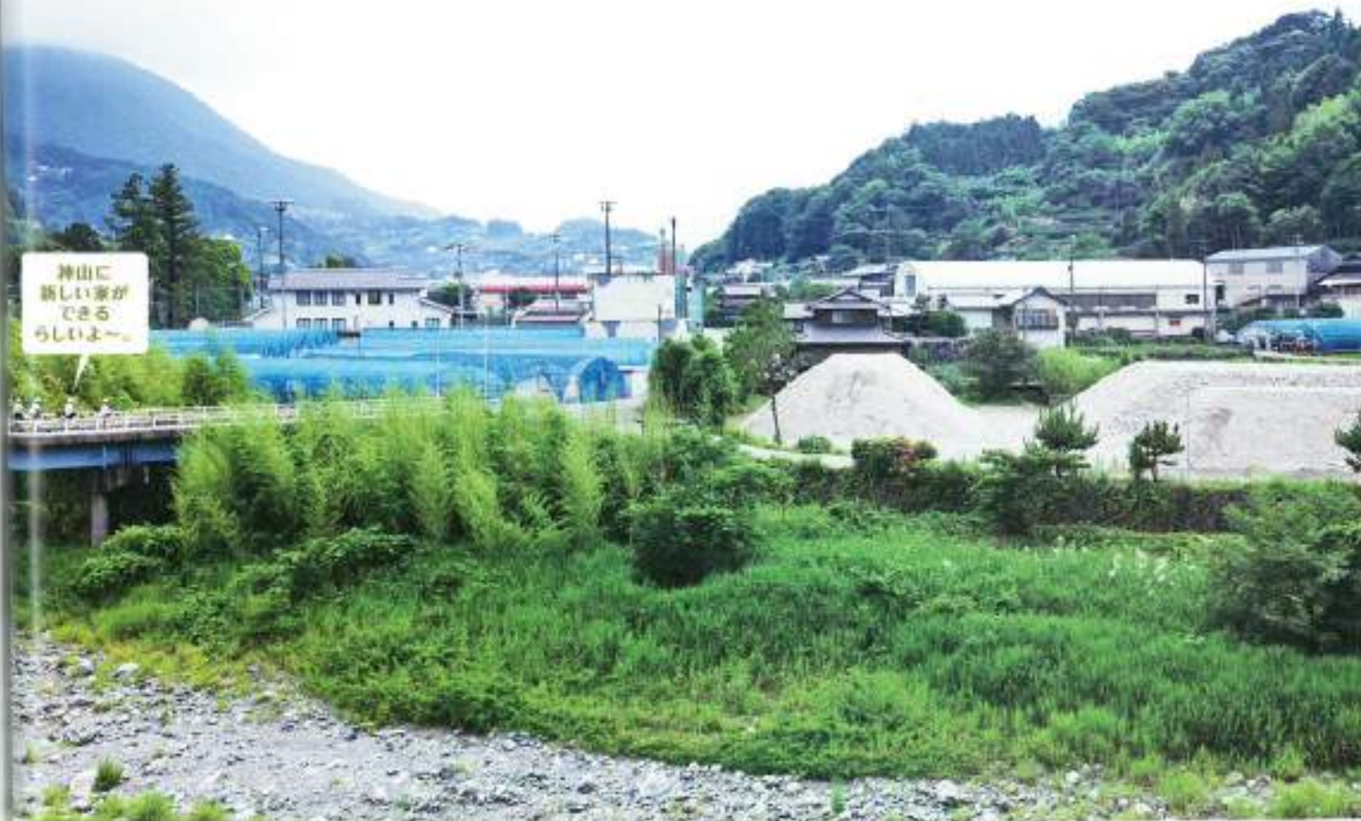
鮎喰川の向こうに暮かれたコンクリートが積まれている場所に、「大整地集合住宅」は建設される。
